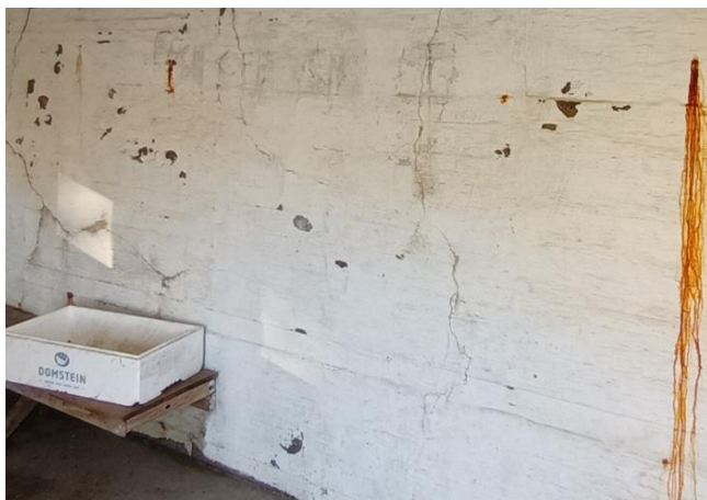
Figur 8. Avskallende maling i venteskuret.
