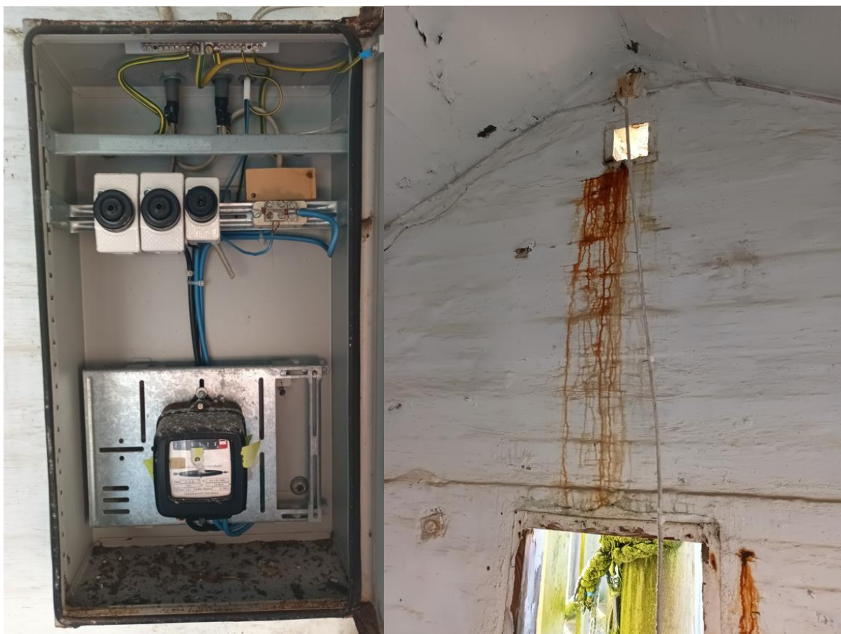
Figur 9. Vestre bilde: strømskap og dets innhold er EE-avfall. Høyre bilde: strømkabel er EE-avfall..
